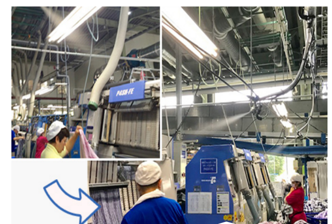
リネン工場 導入台数：190台 スポットエアコンをクールミストLineに変更。クールミストLineは、作業者のいる所が涼しくなり、スポットクーラーに比べ調節がしやすい。作業体制が変わったときも大きな設備変更が要りません。スポットクーラーを全て撤去して電気代も20%近く削減しました
