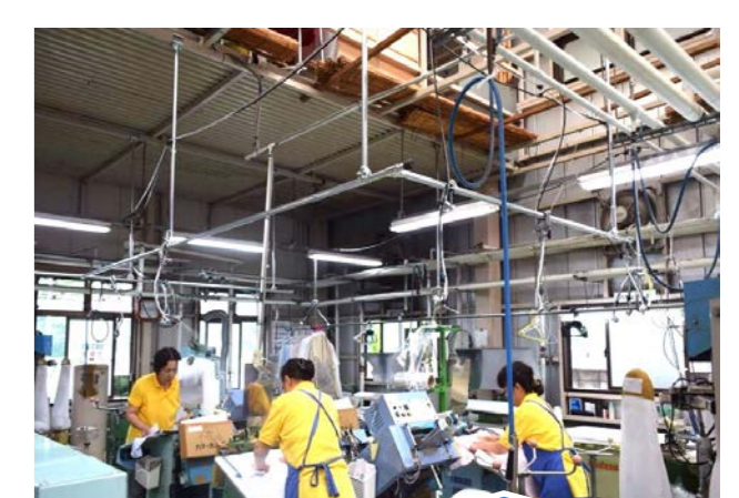
クリーニング工場 導入台数：36台 40℃以上になる工場で天井が高い為20年間暑さ対策が出来ず困ってました。クールミストLineを紹介され導入致しました。従業員も喜び、熱中症で倒れる事が無くなりました。
