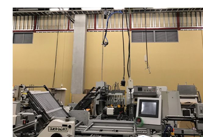
印刷製本工場 導入台数：20台 水道設備の無い工場で、ボトル5L(1台用)を使用して取付けました。印刷の現場で水を使うのは当初とても心配していましたが、問題なく使えています。夏は冷却で、冬は加湿と耐電防止として一年中活躍しています。
